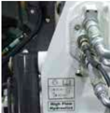
Circuit hydraulique secondaire grand débit
